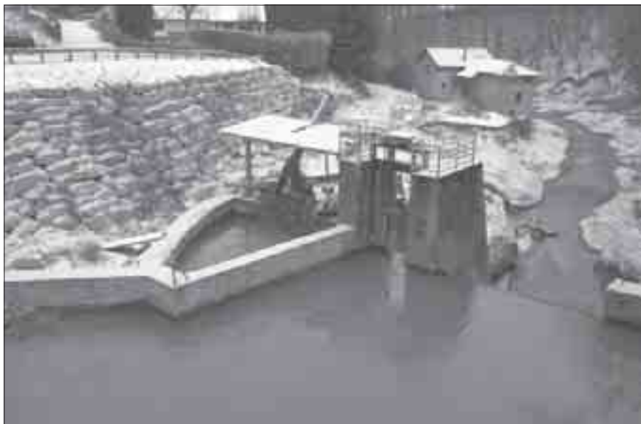
La micro-centrale hydroélectrique de Saint-Beuil en Isère existe depuis 1922
